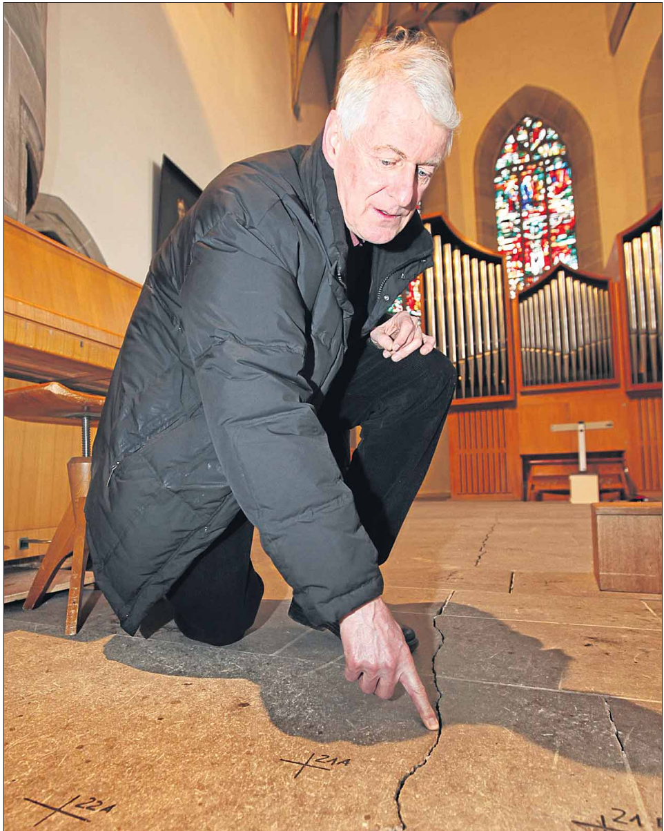
Beispiel Martinskirche: Risse in Boden und Mauerwerk müssen wohl aufwendig saniert werden.
