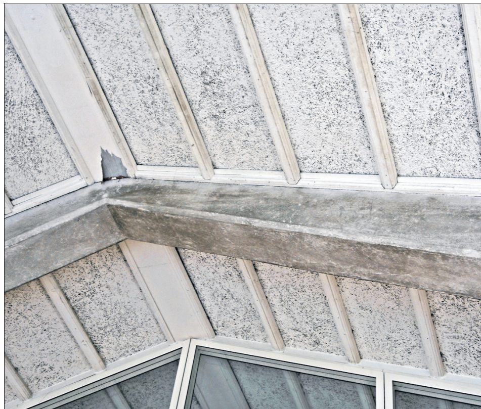
Schimmel an Querleisten und Trägern plagt die Heiliggeistkirche in Pattonville.
